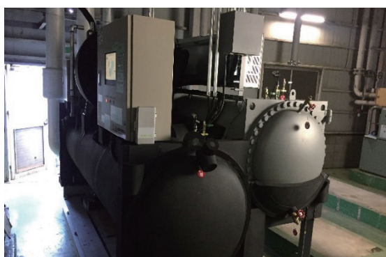
高効率ターボ冷凍機
