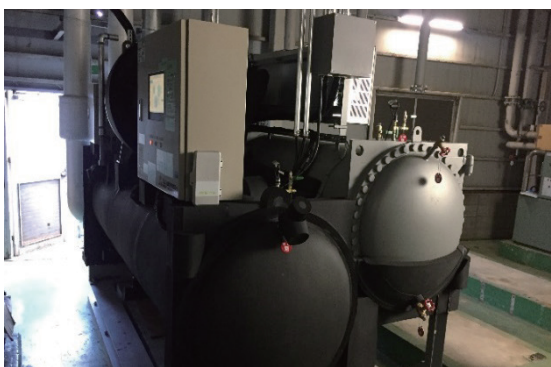
高効率ターボ冷凍機
