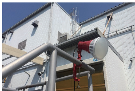
灯光器の LED 化（和歌山プラント）
