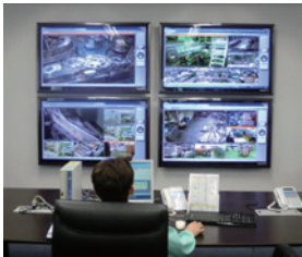
「見える化」により、コントロール室が完成
